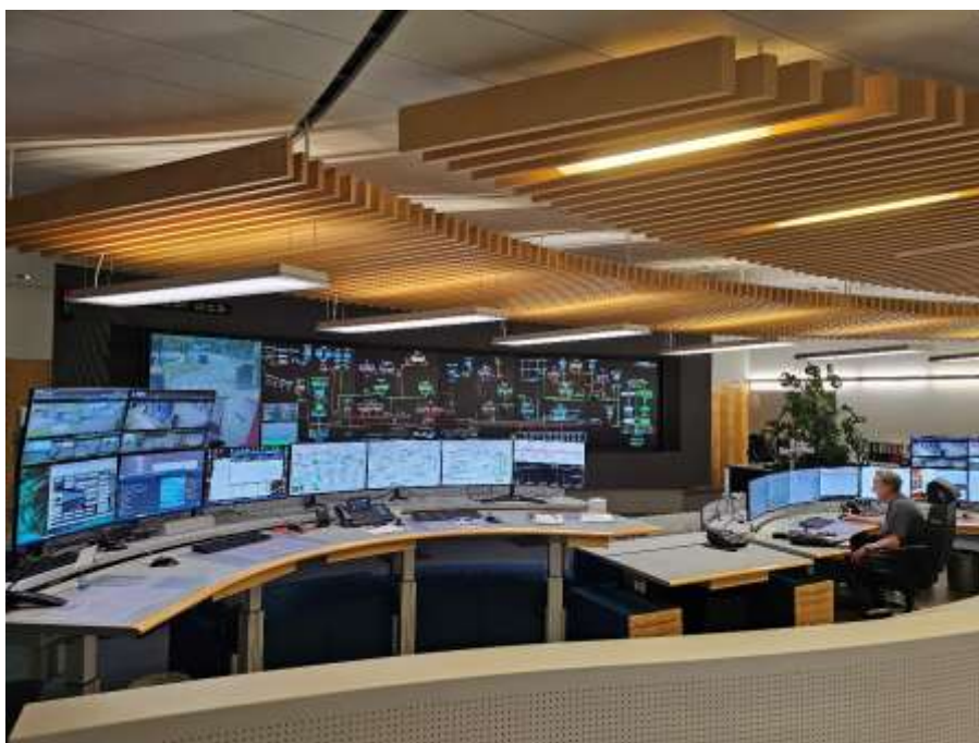
Obr. 8.: Úpravňa vody Das Grundwasserwerk Hardhof - dispečing
