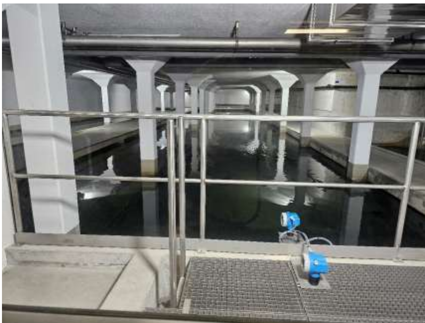
Obr. 6. Úpravňa vody Das Seewasserwerk Lengg – filtrácia cez aktívne uhlie
