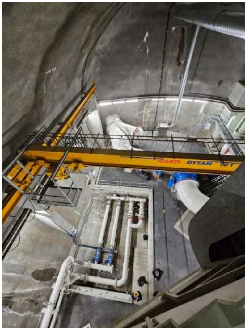
Obr. 9.: Vodojem Lyren – armatúrna komora na dne šachty
