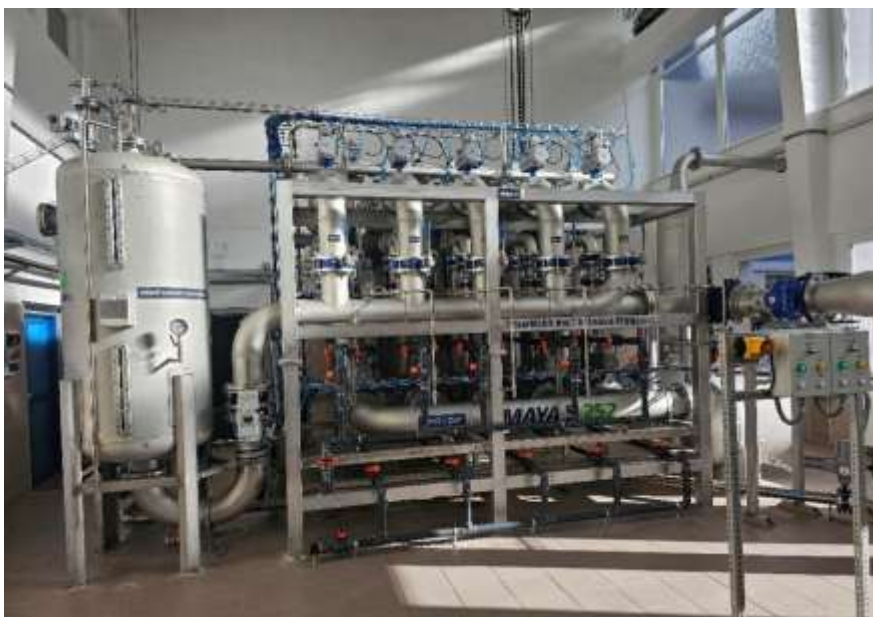
Obrázok 5. Úpravňa vody Klenovec – keramická membránová mikrofiltrácia
