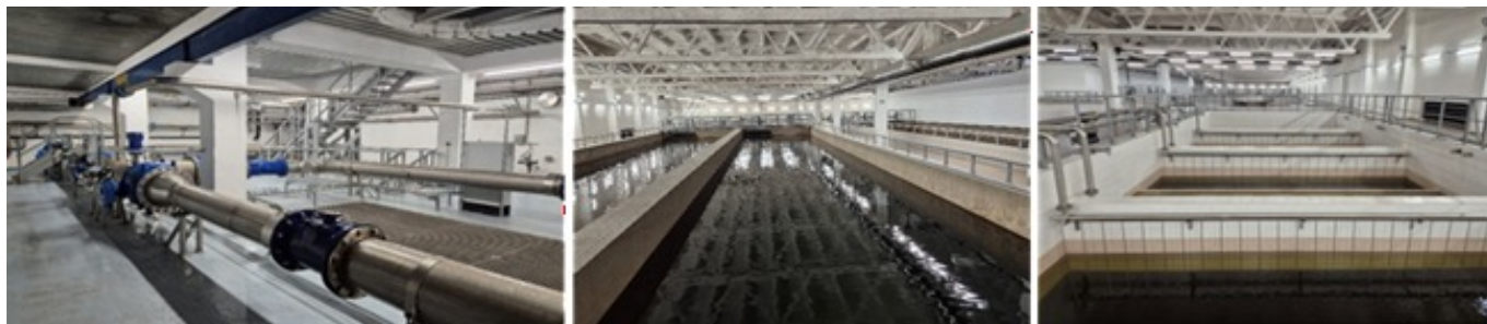
Prívodné potrubie vody z VN Málinec do úpravne, usadzovacia nádrž a hala filtrov
